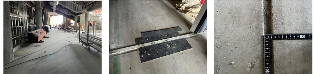
荒れた走行路面
